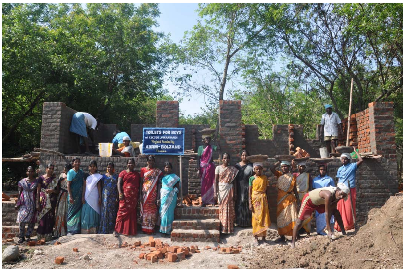
Costruzione dei servizi igienici al Ceco'de, finanziata dalla donazione di un nostro sostenitore
